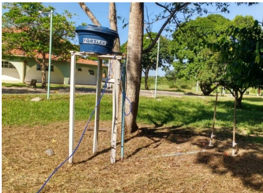
Figura 12 – Unidade Demonstrativa de um carneiro hidráulico no IFPA Campus Castanhal. Fonte: Acervo próprio.
