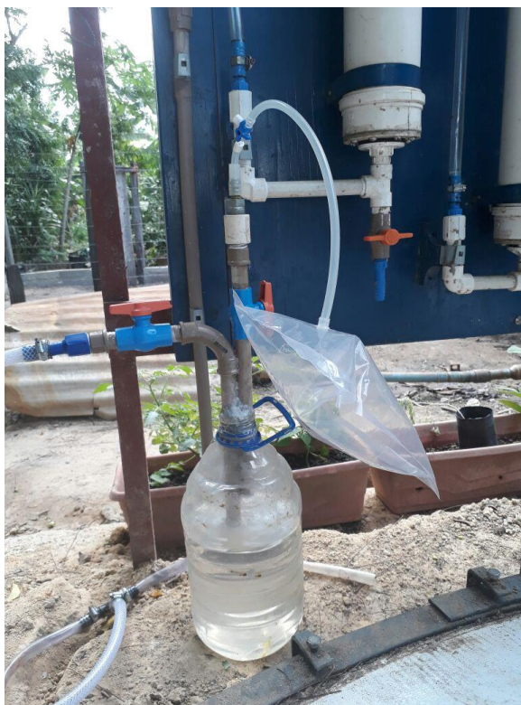
Figura 2.4: Filtro Purificador de Biogás.
