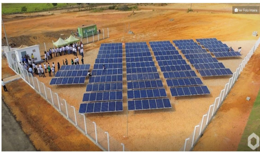
Figura 66: Instalação da Cooperativa Brasileira de Energia Renovável (Coober) instalada em Paragominas-PA.
