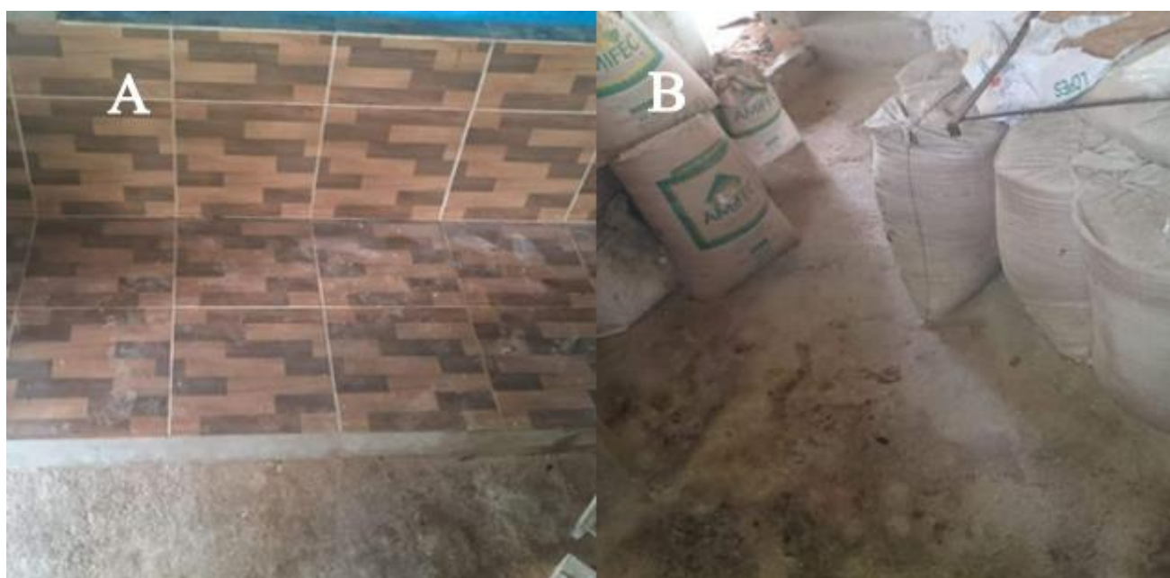
Figura 3. Edificações e instalações da agroindústria, A: Piso misto de cimento e cerâmica em cor escura e B: piso desgastado e sujo
