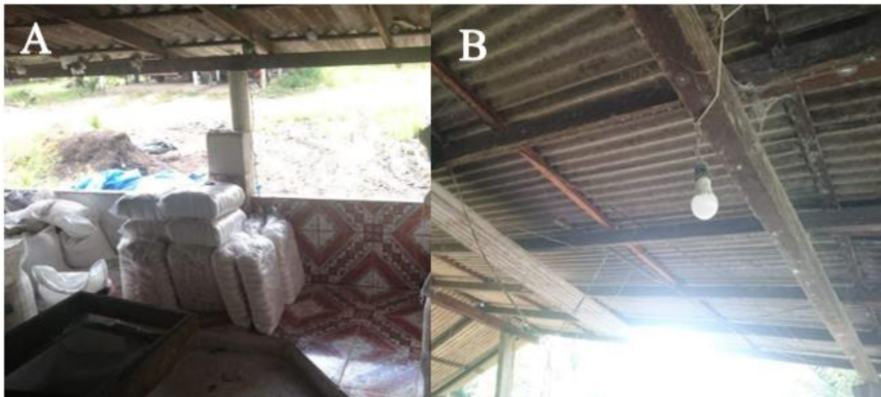
Figura 4. Edificações e instalações da agroindústria, A: Paredes incompletas e sem proteção contra vetores e pragas e B: Teto sem forro, sujo com teias de aranha e instalações elétricas expostas
