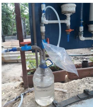
Figura 8. Filtro Purificador de Biogás.
