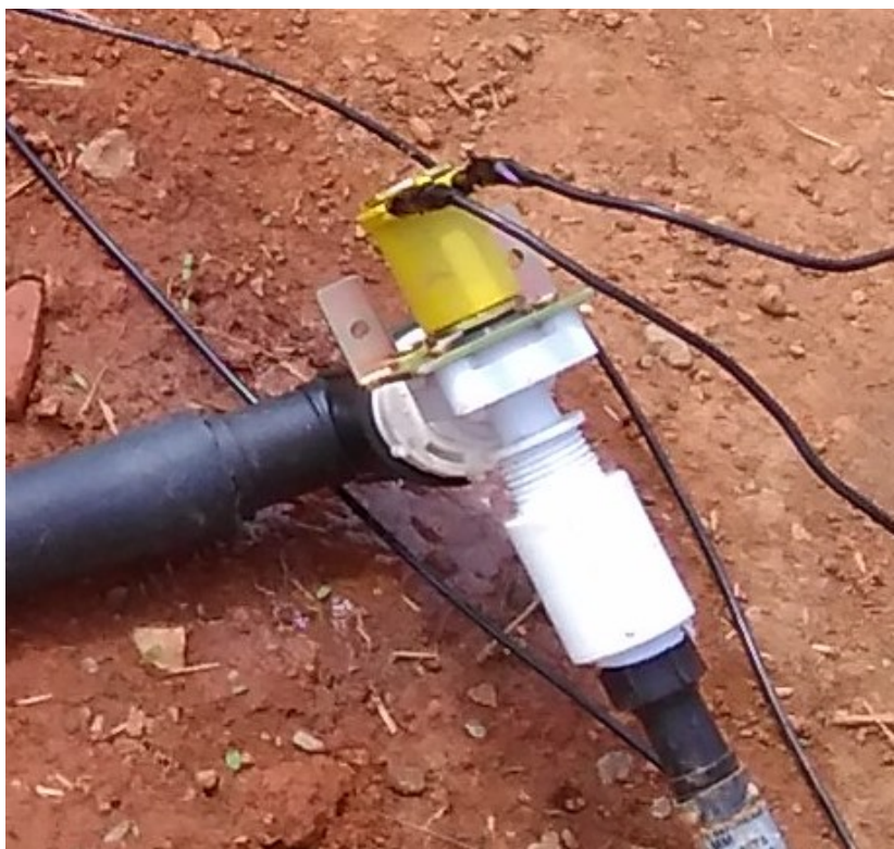
Figura 9 – Válvula de controle de irrigação
